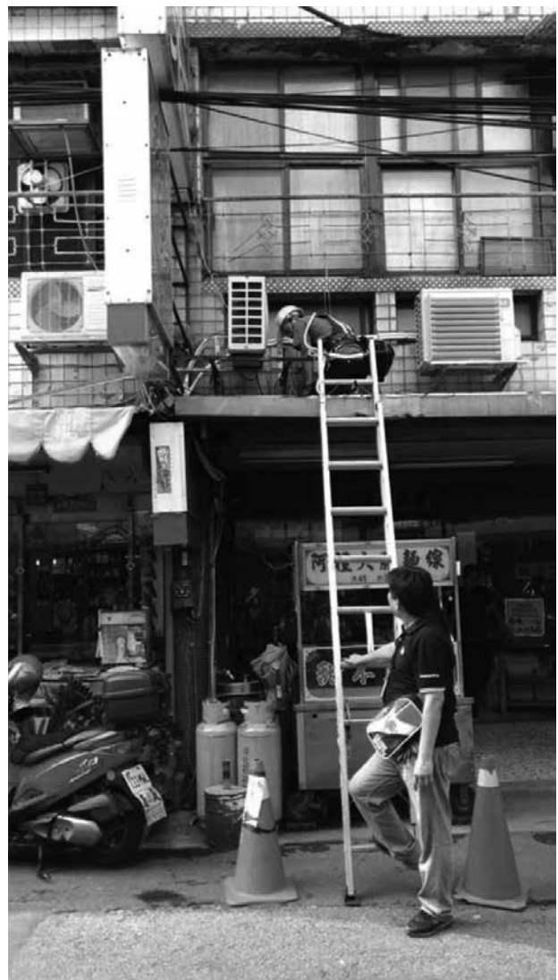
戶外冷氣機年久失修易漏電，維修作業前應先斷電、再檢電。
